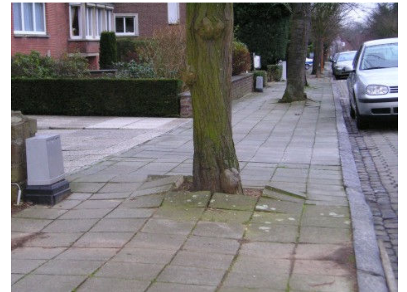
Avenue du Kouter : les racines des cerisiers ont détruits les trottoirs, ce qui bien sûr n'est pas à l'avantage du piéton.
